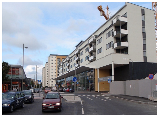
Påbyggnad med volymelement ovanpå befintligt parkeringshus 2006-08 genomfördes i samband med moderniseringen av den klassiska abc-staden Vällingby, Stockholm
